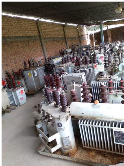
Almacenamiento de transformadores usados
