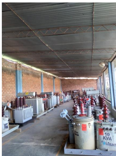
Figura 1. Almacenamiento de transformadores nuevos
