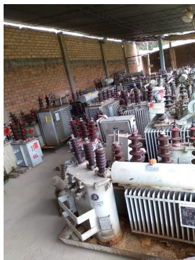
Figura 6. Almacenamiento de transformadores usados
